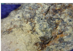
شکل ۱۷. ریزترک‌های موجود در سطح
